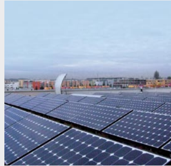
Solarmodule auf einem Flachdach im Scharnhäuser Park
